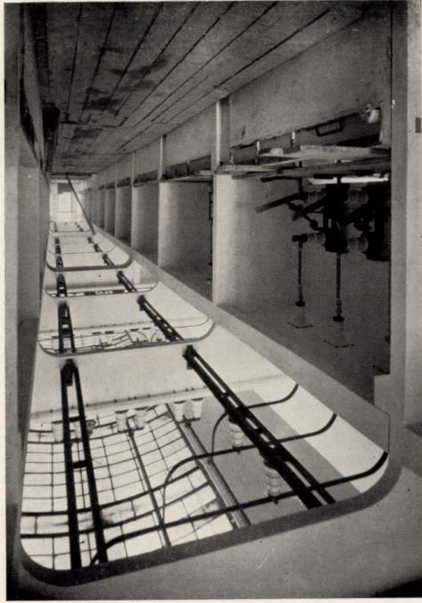
Dr. Bierbauer Virgil: A keletföldi 30.000 Voltos elek- tromos kapcsolóház szakaszkapcsoló cellasora. Fenn a vezetősínek. (1929)
