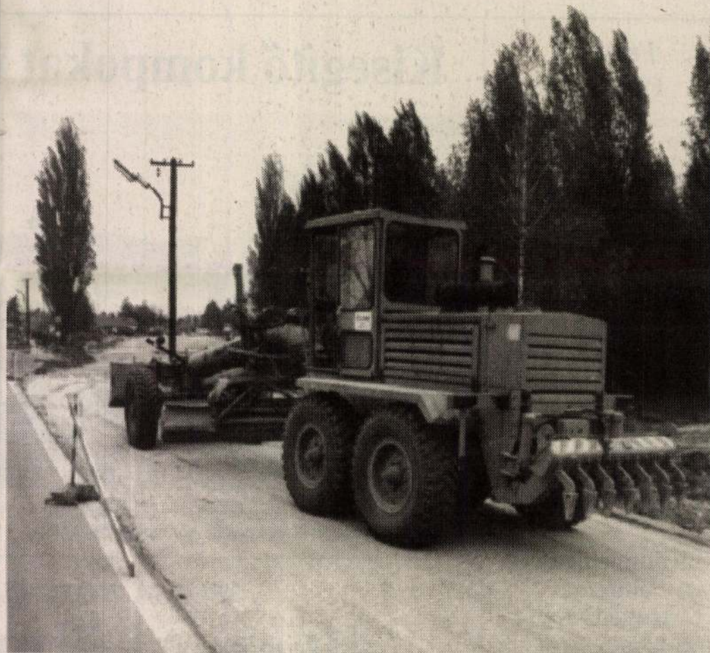
A Strabag Hungaria Építő Kft 160 millió forintos beruházás keretében építi a 76/A főút siófoki nyugati kivezető szakaszát. Naponta 7-8 munkagép végzi a munkálatokat. A tervek szerint az útszakaszt június 30-án adják át a forgalomnak.
